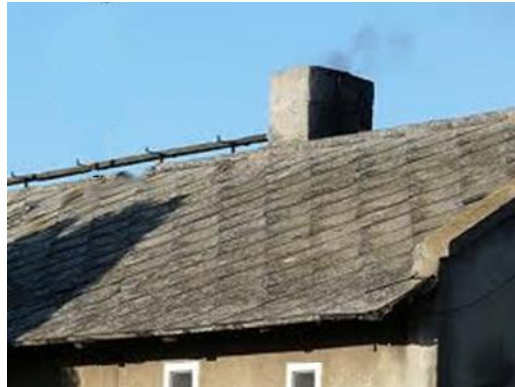
Rysunek nr 4. Płyta azbestowo-cementowa karo.
