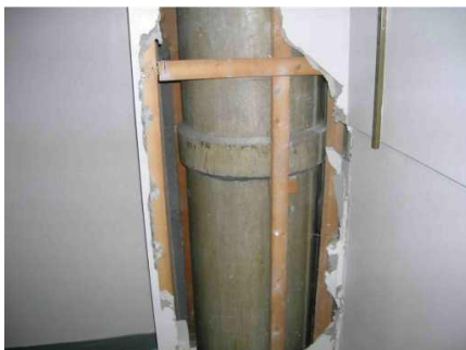
Rysunek nr 6. Azbestowo-cementowy kanał dymowy z obudową z płyty azbestowej.
